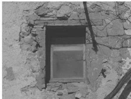
Feuillure de fenestron en mortier de plâtre fortement cuit de teinte rose (Peyroules)
